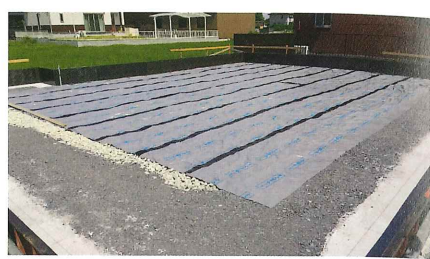
2 リサイクル発泡ガラス砕石の上に防蟻シートを敷いた
