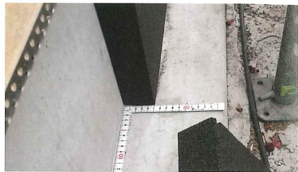
3 基礎立上り部分に、シロアリが食べられない発泡ガラスボード50mmを接着
